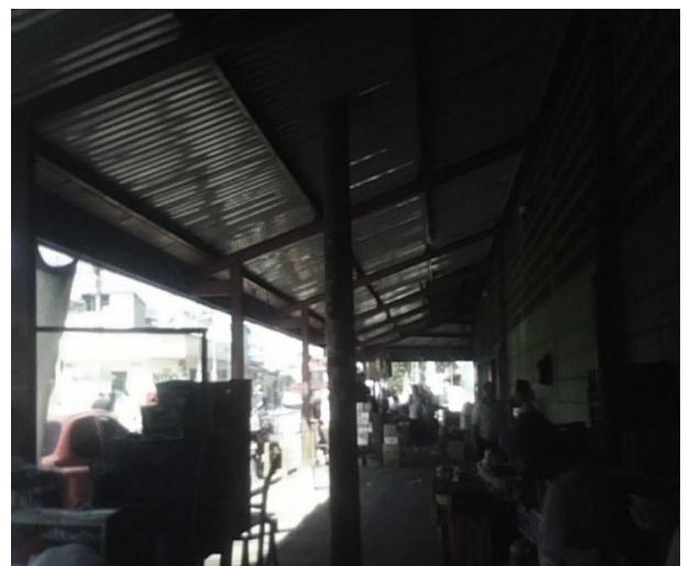
FOTO No. 13 HERBERT COP, AÑO 2010, MUESTRA LA ESTRUCTURA INTERNA DEL ESTABLECIMIENTO CON LAS PENDIENTES EN LOS TECHOS
