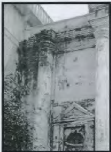
Foto 59: Humedad, grietas y presencia de microflora Jackeline González, 2009.
