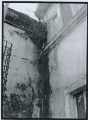
Foto 55: Grietas, humedad, crecimiento de macro y microflora Jackeline González, 2009.
