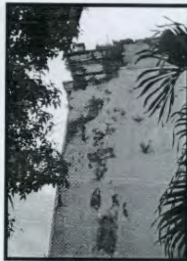
Foto 58: Humedad, grietas y macroflora Jackeline González, 2009.
