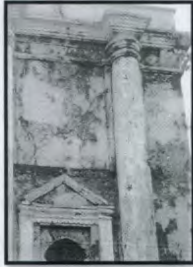
Foto 68: presencia de micro flora, humedad y grietas Jackeline González, 2009.
