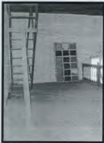
Foto No. 53 Se observa el refuerzo improvisado en módulo de gradas. Acceso a campanario Jackeline González, 2010
