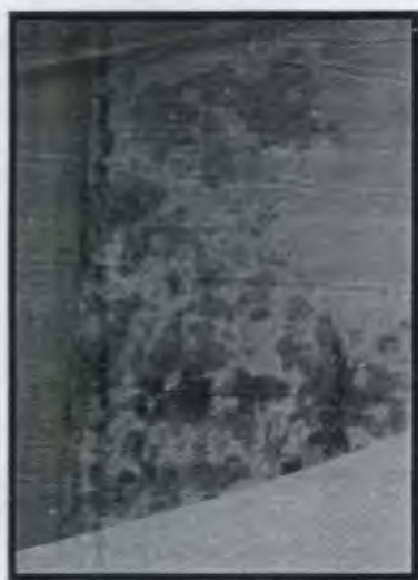
Foto 61: Humedad, grietas y presencia de microflora Jackeline González, 2009.
