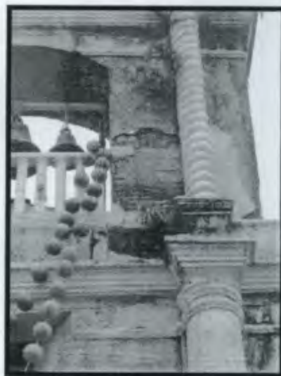
Foto 64: presencia de microflora, desprendimiento de repello, grietas y humedad Jackeline González, 2009.
