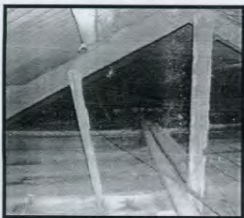
Foto 65: Tijeras deterioradas y mal reforzadas Jackeline González, 2009
