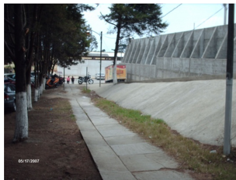
Vista de Caminamiento peatonal y muro de contención donde se construye actualmente un área de parqueos en el Complejo Hospitalario
