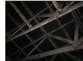
Foto No. 40 Deterioro y daños en la estructura del techo.
