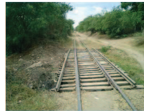
Foto No. 97 Paso aéreo de la vía debido a corrientes de agua en época de invierno.
