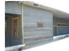
Foto No. 54 Deterioro en la parte baja de los muros del edificio.
