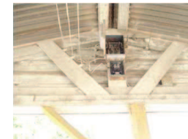
Fotos No. 62 Se observa deterioro en el sistema eléctrico.
