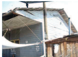
Foto No. 56 Muro y cielo falso de madera, destruido.
