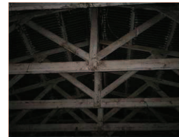
Foto No. 57 Daños en la estructura de madera que soporta la cubierta.
