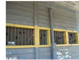
Foto No. 50 Deterioro en la malla de las ventanas del área de bodega.
