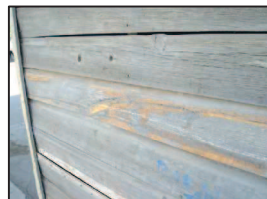
Foto No. 52 Daños en muros por vandalismo y falta de mantenimiento.
