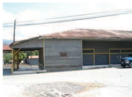
Foto No. 51 Daños en la cubierta y canal, están oxidadas y algunas partes destruidas.
