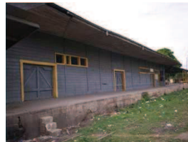
Foto No. 39 Daños en la estructura de concreto, que es la base del edificio.
