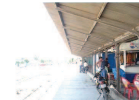
Foto No. 58 Estructura del andén de carga, muestra óxido y desgaste.
