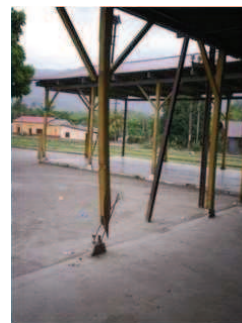
Foto No. 61 Daños en las columnas del andén de pasajeros.
