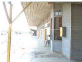
Foto No. 47 Deterioro en el piso del andén de la estación.
