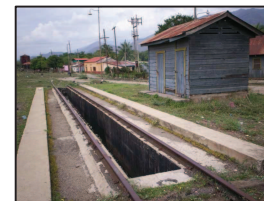
Foto No. 31 Edificio de Taller con fosa, utilizado para la reparación de máquinas.
