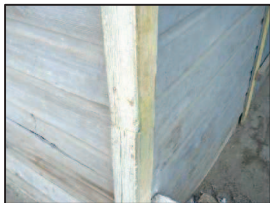
Foto No. 55 Se observa deterioro en muros y pisos del edificio.
