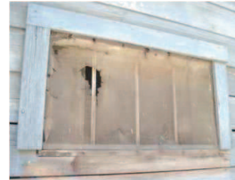
Foto No.49 Faltante del marco de ventana y daño en malla.
