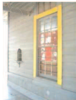
Fotos No. 60 Daños en ventanas.
