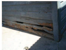
Foto No. 48. Daños a causa de las lluvias.
