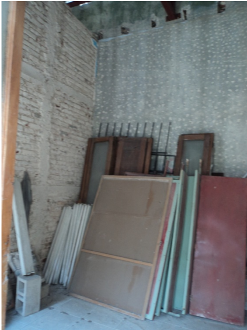
Expone la falta de acabados en muros y el abandono de puertas y ventanas.
