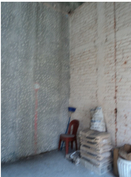
Expone faltante de acabados en muros de Mampostería de ladrillo.
