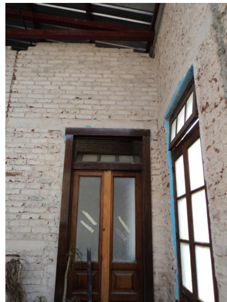
Expone el deterioro en puertas y ventanas.
