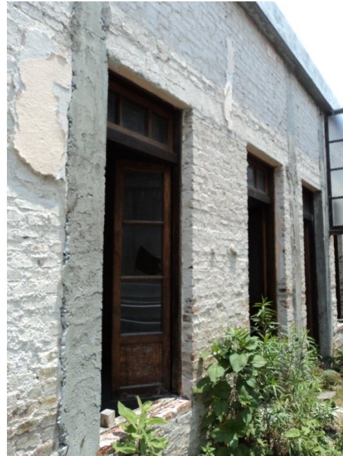
Expone material sobrante en el patio central, falta de cubierta y ventanas.
