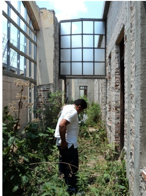
Crecimiento de micro y macro flora, producto De la falta de mantenimiento.
