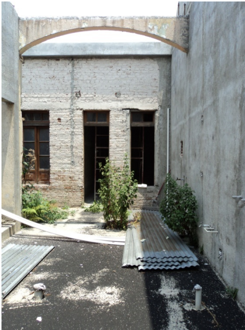
Detalle del abandono interior en el que se encuentra el inmueble.
