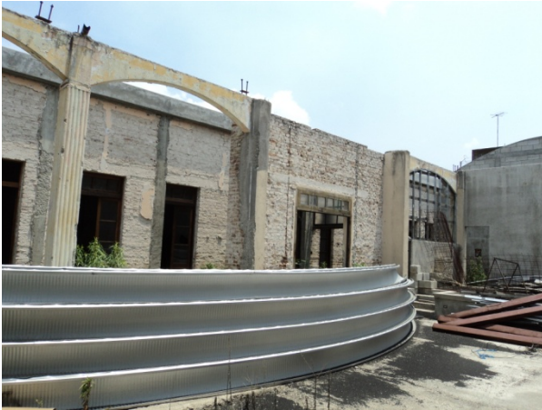
Obsérvese el abandono del patio central.
