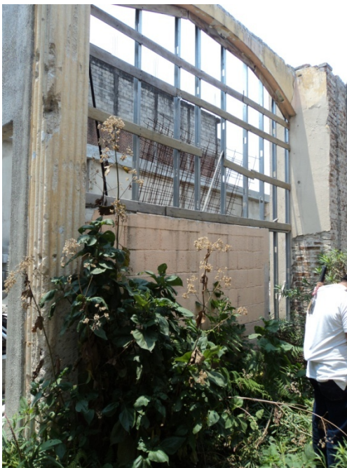
Desprendimientos de material, manchas, humedad y grietas.
