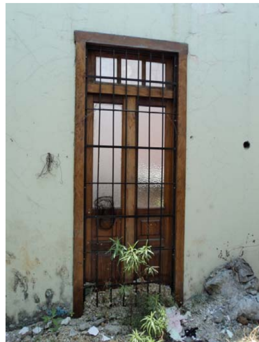
Obsérvese el estado de las puertas y la cantidad de material sobrante en los pisos.
