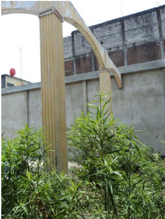
3 Obsérvese la falta de mantenimiento y abandono del inmueble.
