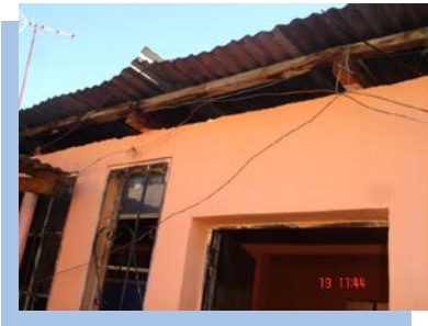
Fotografía No.2 Cubierta en mal estado municipalidad de Santa Cruz Balanya Fuente: Elaboración propia
