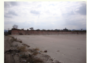
FOTOGRAFÍA NO. 23: Se observa que el terreno anteriormente era irregular con pendiente, pero se observa el movimiento de tierra efectuado, logrando que esté totalmente plano con pendiente no mayor al 3%.
