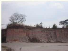
FOTOGRAFÍA NO. 22: Se puede observar una tubería de PVC, por lo que se demuestra que existe la posibilidad de introducción de agua potable, aunque no se encontraron rastros de conexión con drenajes sanitarios, como parte de infraestructura existente.
