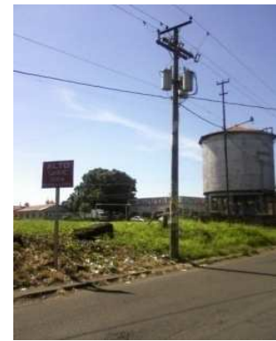
En el área existe servicio de transformadores y alumbrado público
