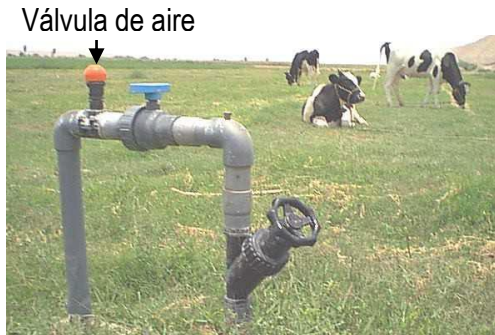
Imagen 351 Arco de riego o llave de paso con válvula de aire incluida Fuente: Ing. José Pinto Villanueva. --Ing. Itay Pinto.
