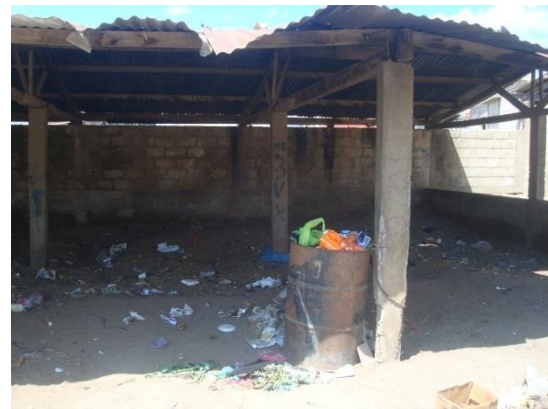
Foto 22 se observa el estado actual externo de la fachada posterior debido a la tormenta Stan en noviembre del año 2006.
