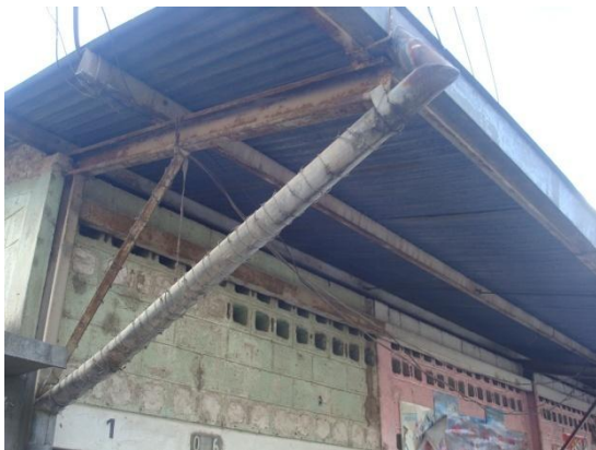
Foto 21 se observa el estado actual externo del techo en la fachada principal del mercado Fuente: por cuenta propia
