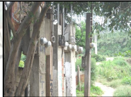
Imagen 4: La infraestructura para la distribución del servicio eléctrico, se encuentra colocada en muros aislado rodeado de vegetación. Fotografía del autor, 2010
