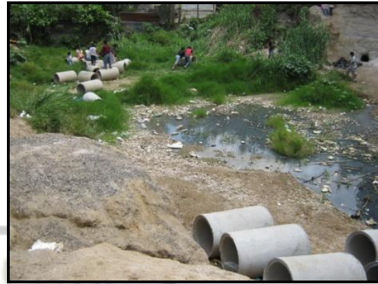
Vista F: Esta imagen muestra parte del terreno donde existe agua estancada ya que la tubería de drenaje que se encuentran realizando aún no ha sido terminada, así mismo muestra la vegetación junto a los materiales de construcción que se utilizan para la tubería. Fotografía del autor, 2010
