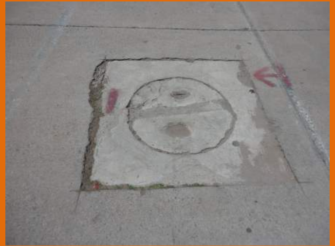
Candela de Drenaje Municipal
