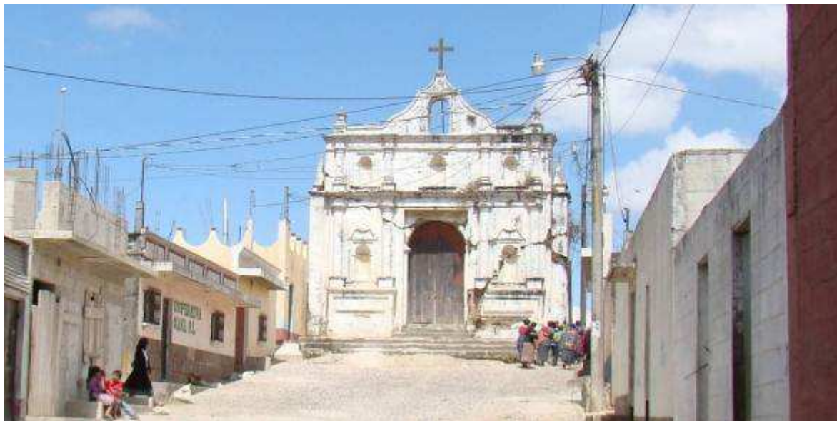
Fotografía 2: segundo templo construido, El Calvario está ubicado 300 metros del primer templo, este templo está clausurado debido al colapso estructural que presenta. Fuente propia.
