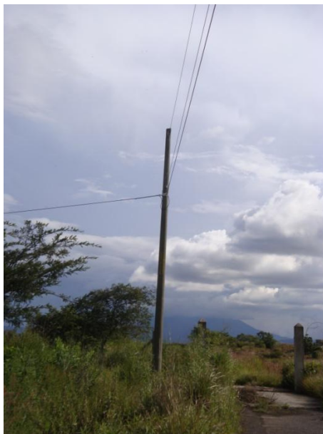
Fotografía No, 16 Acometida eléctrica existente, Fuente: Propia
