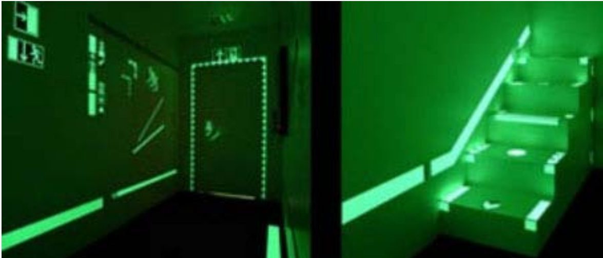
Ilustración 400, aplicación de señalización fotoluminiscente a rutas de escape
