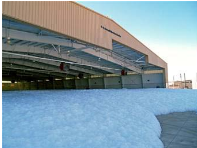
Ilustración 201, sistema de espumas de alta expansión
