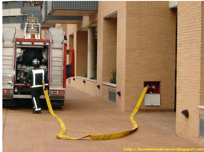
Ilustración 172, toma de columna seca en fachada y acople a camión bomba
