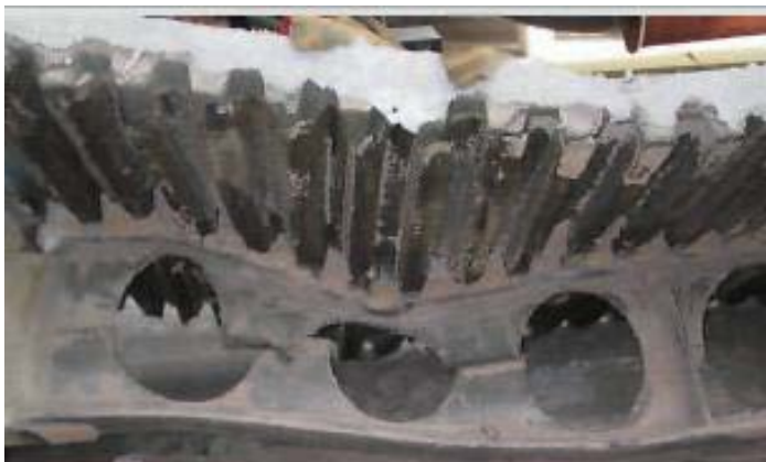
Ilustración 82, Viga Celular dañada por fuego en un incendio real
