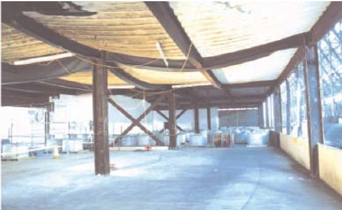
Ilustración 286, estructura de acero después de un incendio, sin recubrimiento intumescente a prueba de fuego, presenta fallas tipo diafragma
