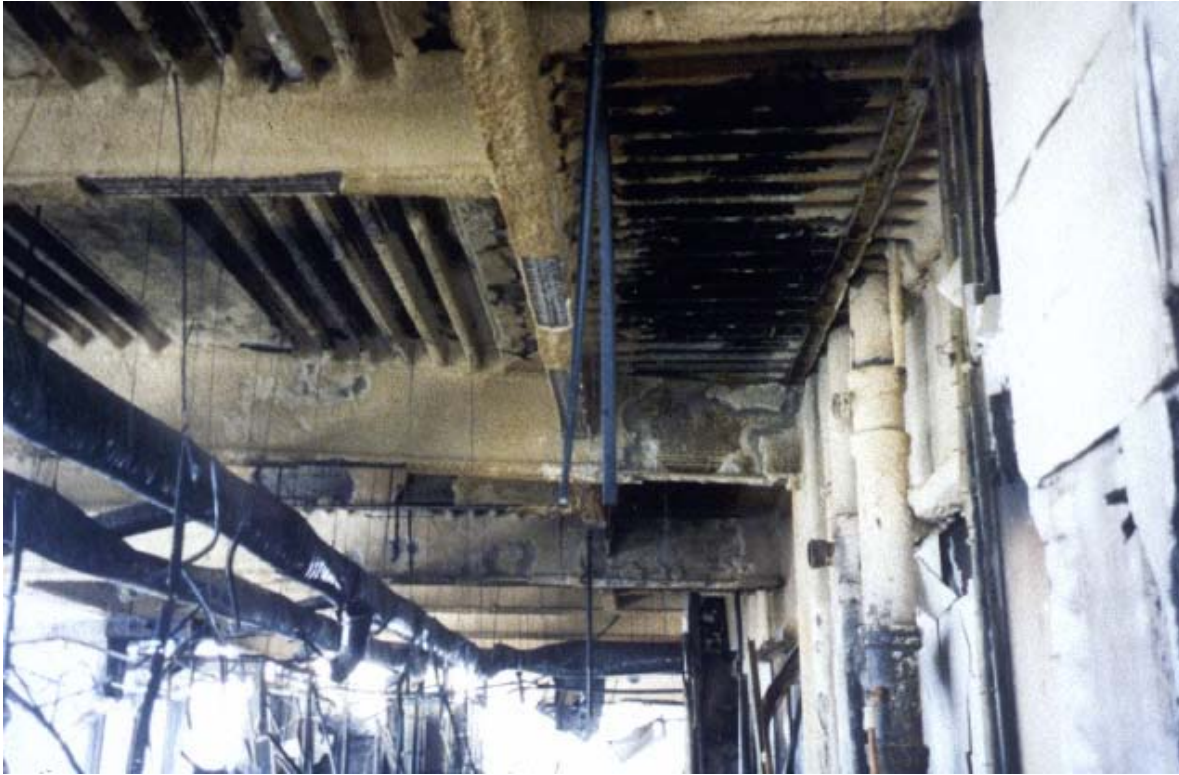
Ilustración 285, estructura de acero después de incendio, fue tratada con recubrimiento intumescente, el incendio consumió todo el material combustible, y la estructura aun es recuperable
