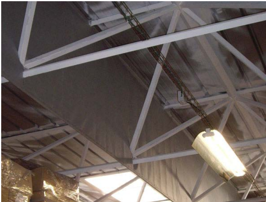
Ilustración 371, cortina fija para confinamiento y extracción cenital de humo de incendio, la localización de esta permite la formación del colchón de humo de tal manera que pueda ser extraído por lucernarios o por extractores o exutorios.
