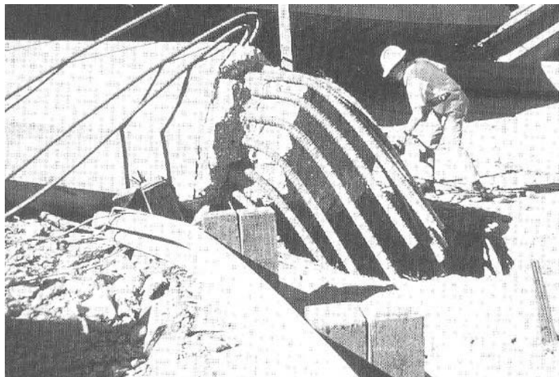
Ilustración 45, falla por Cedencia en el refuerzo de acero
