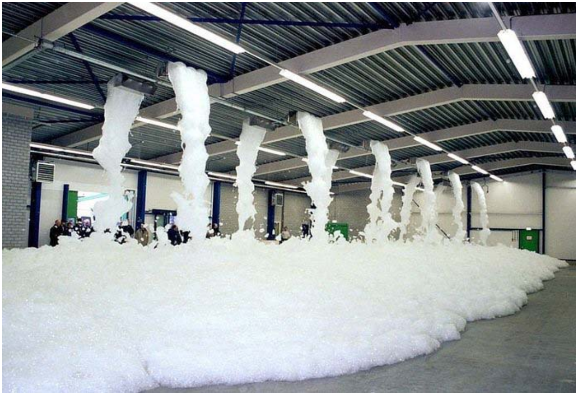
Ilustración 196, sistema fijo de supresión de incendio a base de agente espumante
