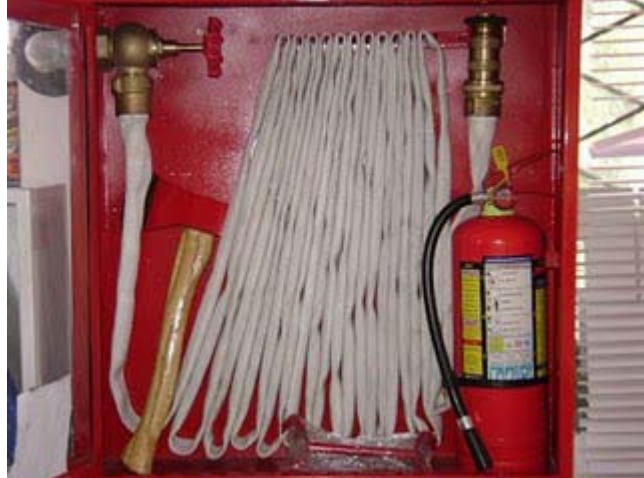
Ilustración 168, Boca de Incendio Equipada
