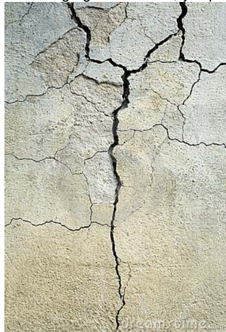
Ilustración 34, agrietamiento superficial de concreto expuesto a altas temperaturas
