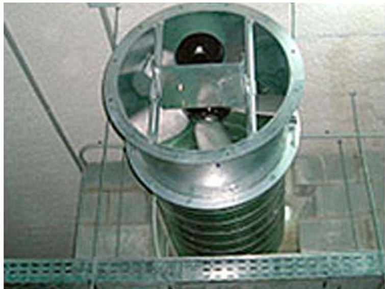
Ilustración 378, equipo ventilador con ducto de extracción
