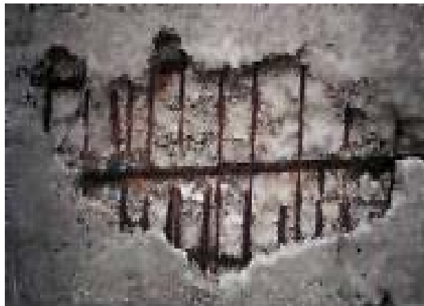
Ilustración 51, diferente grado de exposición de armaduras por efecto de descascaramiento
