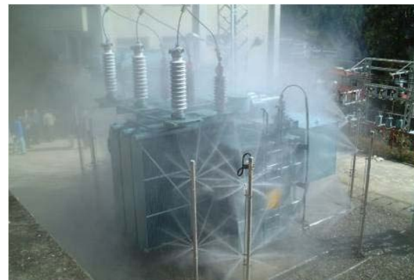
Ilustración 182, aplicación de agua nebulizada en prevención de fuegos eléctricos en bancos de transformadores
