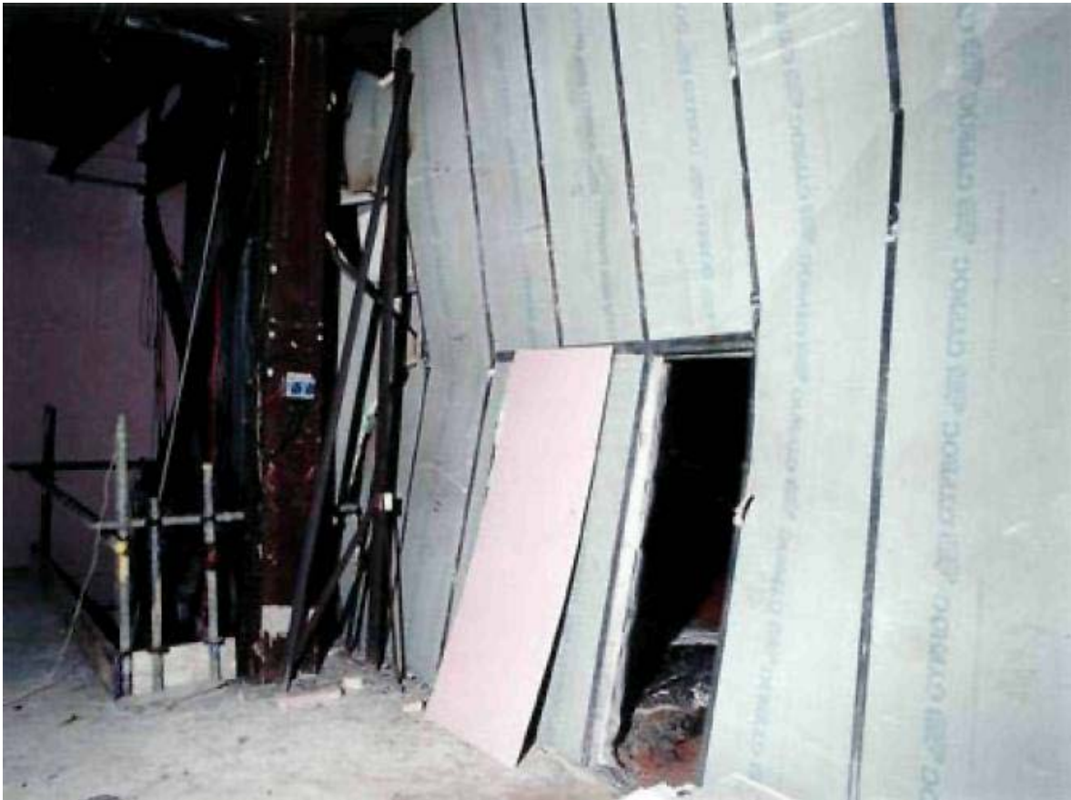
Ilustración 330, ensayo de resistencia en escala real, realizado en Inglaterra, muestra los efectos del fuego en un espacio compartimentado, en esta fotografía se observa la cara no expuesta al fuego. Imagen obtenida de The integrity of compartmentation in buildings during a fire , Building Research Establishment, edición 2005.
