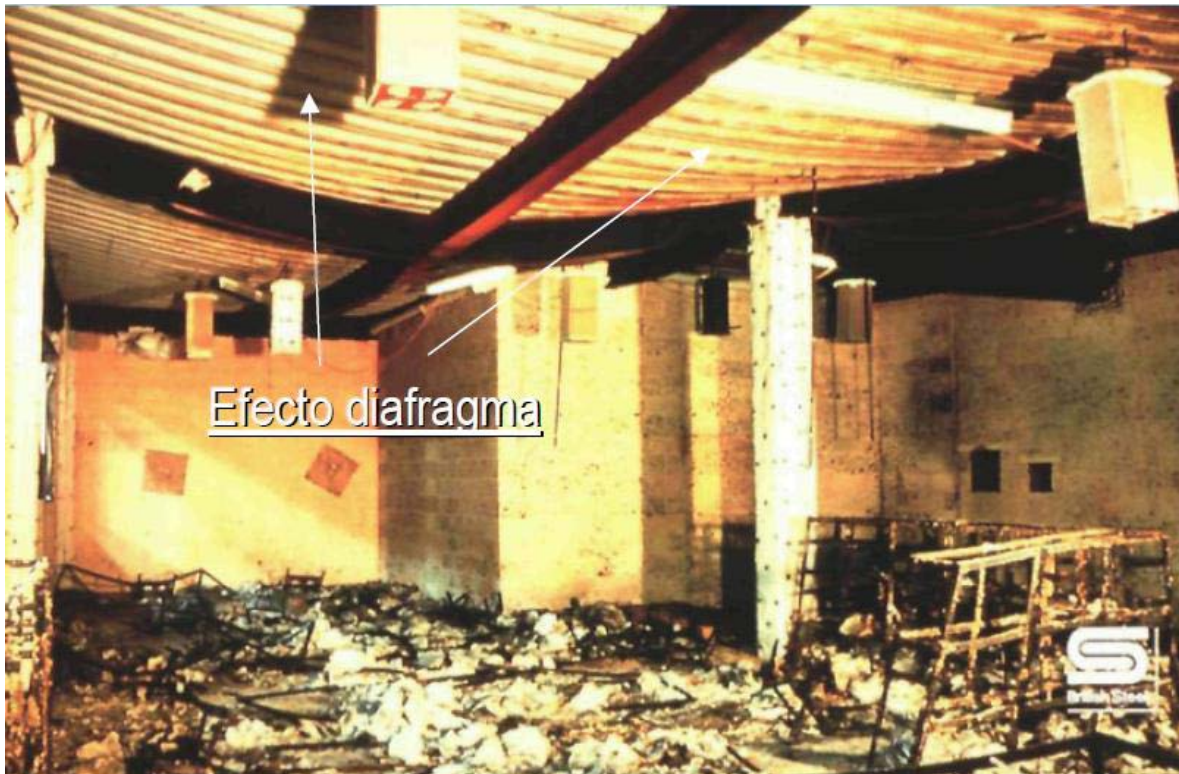
Ilustración 85, Colapso por falla tipo diafragma en una estructura mixta de acero y concreto
