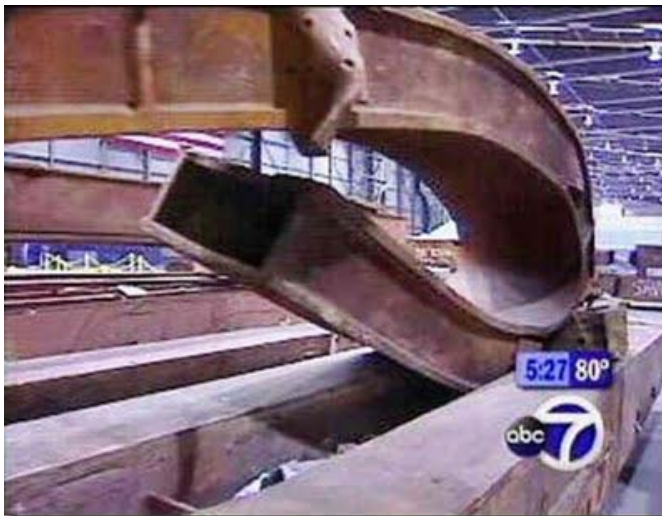
Ilustración 87, falla por fatiga de una columna tubular de sección cuadrada, deformación por efecto de temperatura y aplastamiento
