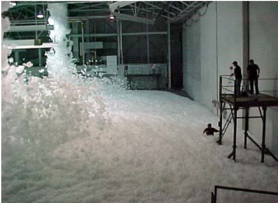
Ilustración 217, altura mínima a alcanzar según normativa NFPA en ambientes inundados de espuma contra incendios
