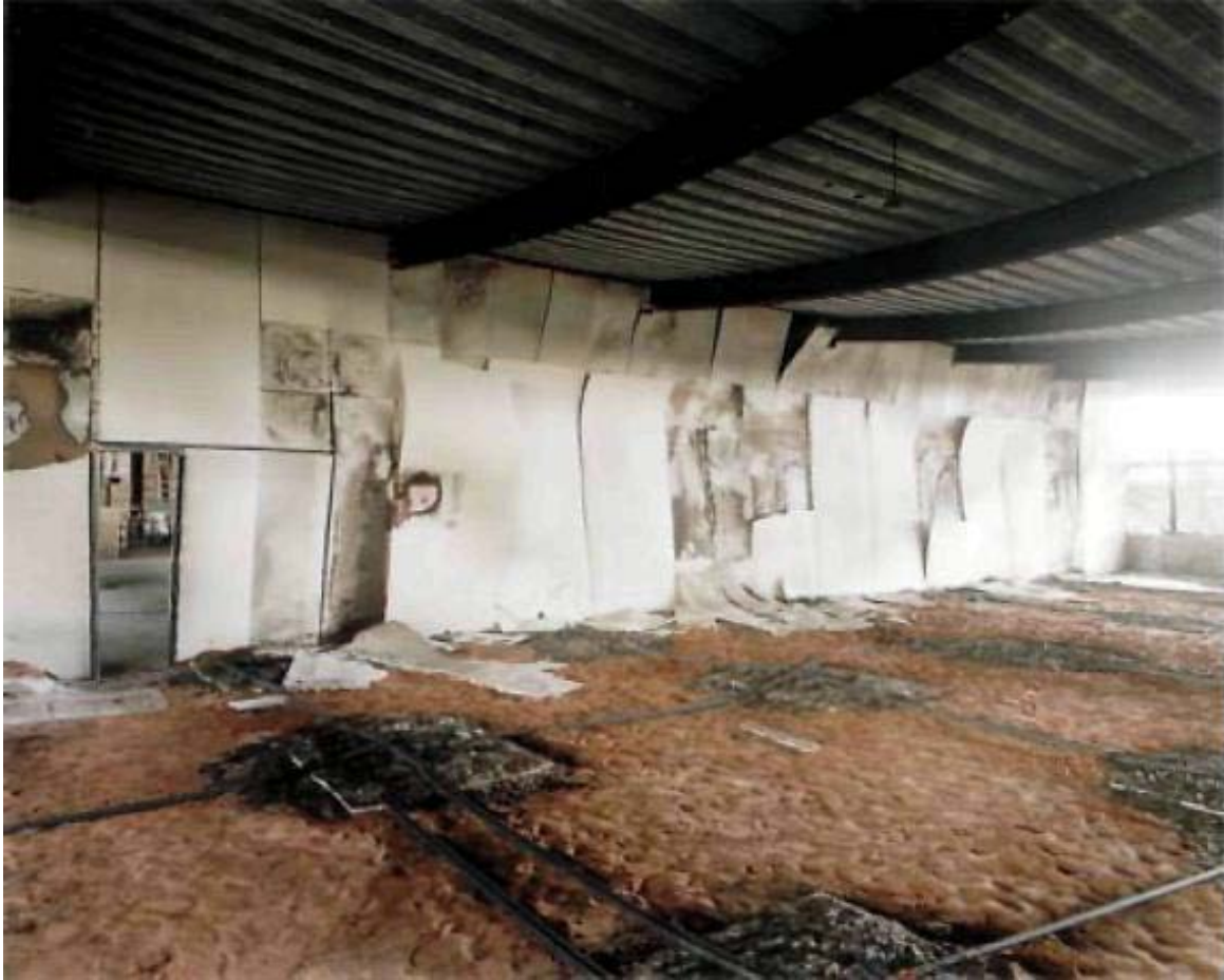
Ilustración 332, ensayo de compartimentación, obsérvese el daño a las estructuras de acero que no fueron tratadas con recubrimiento ignífugo, cuando atraviesan un sector de incendio compartimentado. Imagen obtenida de The integrity of compartmentation in buildings during a fire, Building Research Establishment, edición 2005.
