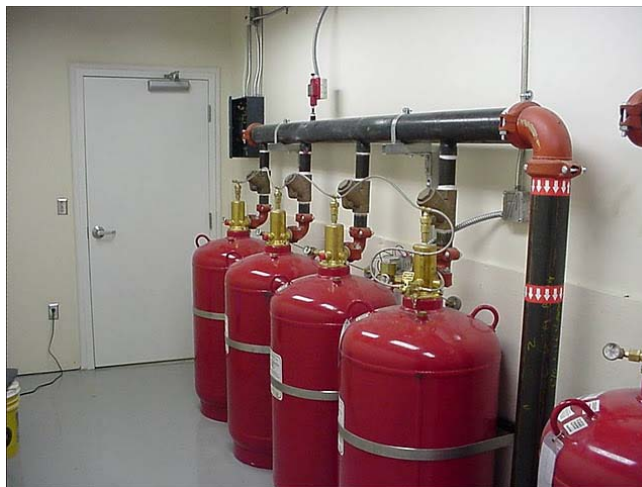
Ilustración 260, Contenedores de Polvo Químico Seco presurizado con nitrógeno
