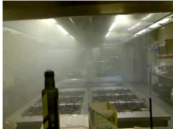
Ilustración 183, sistema de agua nebulizada en cocina industrial
