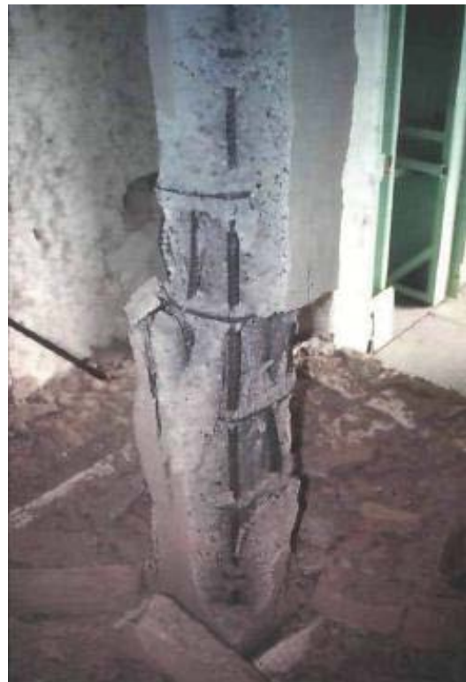
Ilustración 55, daño por fuego en una columna de concreto en condiciones reales
