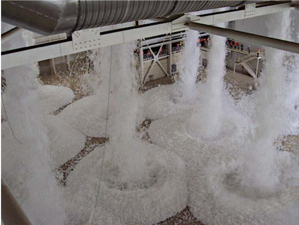
Ilustración 212, descarga producida por un sistema de generadores de espuma de alta expansión, nótese como referencia del volumen el tamaño de la escala humana
