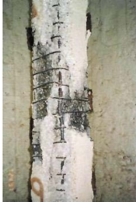
Ilustración 311, columna de concreto sin protección expuesta a los efectos de fuego, obsérvese el descascaramiento y la exposición de armaduras
