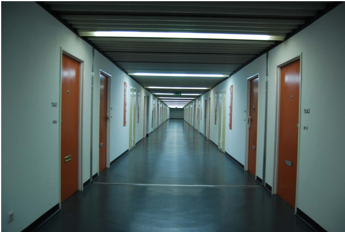
Ilustración 404, Prueba de iluminación de emergencia en corredor de edificio habitacional, Frankfurt, Alemania, obsérvese la distancia entre elementos de iluminación
