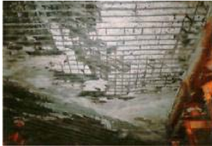
Ilustración 57, exposición de armaduras por efecto de descascaramiento
