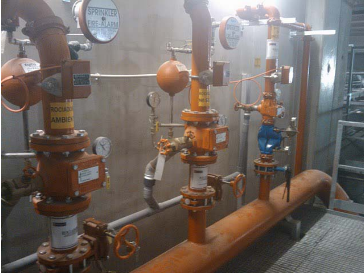
Ilustración 185, línea de tuberías para un sistema fijo de supresión con rociadores
