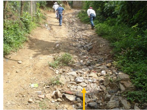
ALDEA EL NARANJO I Los accesos a las comunidades rurales son de terracería y la mayoría se encuentran en mal estado.
