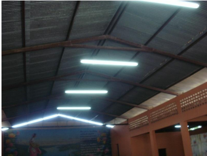
Fotografía 28. Vista interior, estructura de costanera y cubierta de lámina de zinc, Reconstruida en 1978.
