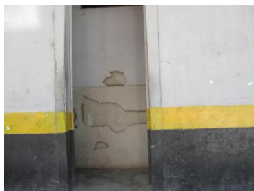
FOTO 4: ROGER GARCIA 2009. MUESTRA EL DETERIORO DE LA ACTUAL ESTACION DE POLICIA.
