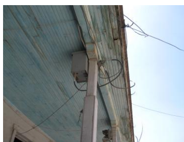
FOTO 5: ROGER GARCIA 2009. MUESTRA EL DETERIORO DE LA ACTUAL ESTACION DE POLICIA.
