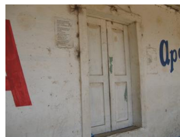
FOTO 3: ROGER GARCIA 2009. MUESTRA EL DETERIORO DE LA ACTUAL ESTACION DE POLICIA.
