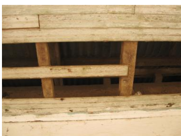
FOTO 1: ROGER GARCIA 2009. MUESTRA EL DETERIORO DE LA ACTUAL ESTACION DE POLICIA.
