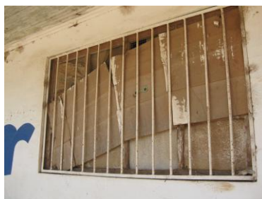
FOTO 2: ROGER GARCIA 2009. MUESTRA EL DETERIORO DE LA ACTUAL ESTACION DE POLICIA.
