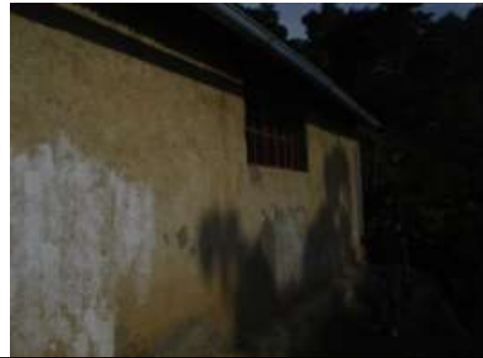
2. Estado Actual de muros en Capilla Católica
