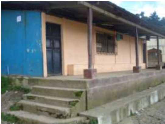
5. Estado Actual de la Alcaldía auxiliar.
