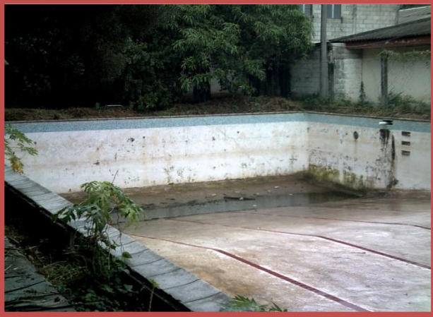
PISCINA MUNICIPAL Abandonada (Noviembre 2,011)
