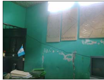
Interior del Edificio Municipal, se puede observar la poca iluminación y ventilación natural que proveen a las oficinas
