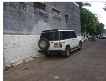
③ Fachada sur del Edificio Municipal, se observa la poca ventilación ubicada en este muro
