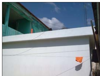
Vista hacia el segundo nivel, se observa el salón de usos múltiples construido en el 1er nivel.
