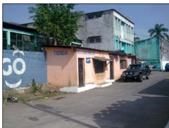
Edificio municipal, se observa el color deteriorado y sin identidad los dos niveles del edificio municipal
