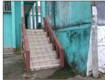
① Ingreso a la Municipalidad a una altura de 2.20mts accediendo por las gradas de concreto, no están niveladas de dimensiones de huella y contrahuella irregulares
