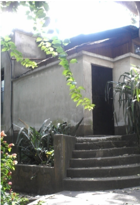
25. Fotografía, fachada posterior izquierda, anexo realizado al CECON en los años 70, igual presenta deterioro por falta de mantenimiento.
