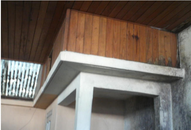
Fotografía 1 Daños por falta de mantenimiento daño por humedad.
