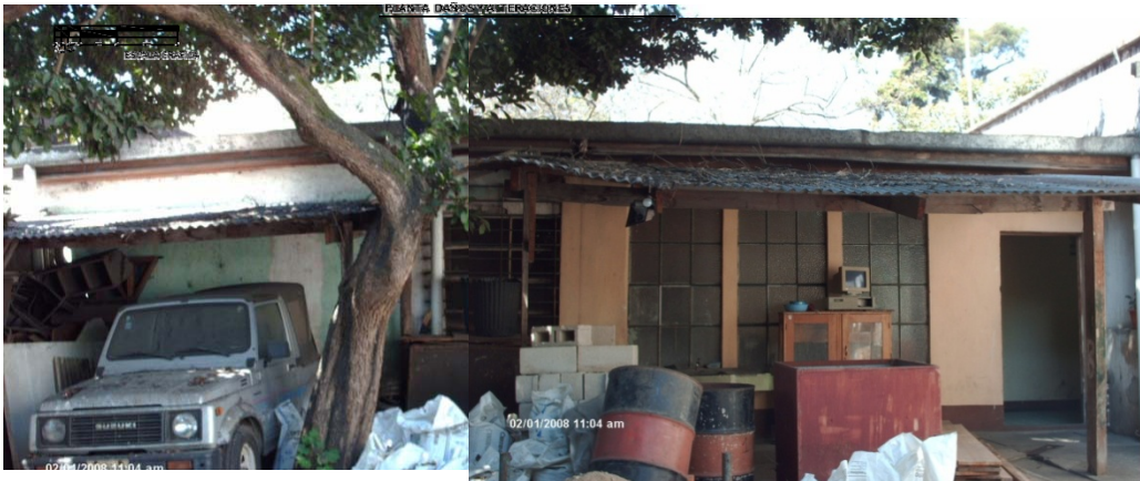
Fotografía 12 Visual de la parte adicionada al edificio original del CECON, se puede observar que la misma se convirtió en bodega de materiales así como que la misma ya presenta daños por falta de mantenimiento.
