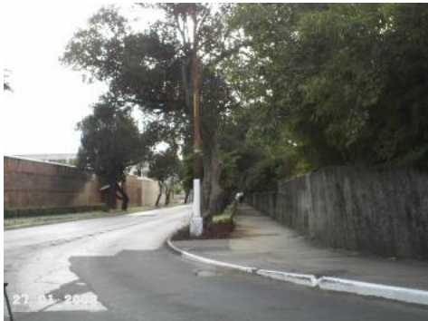
4. Muro vencido por una planta de Bambú CMRO/08
