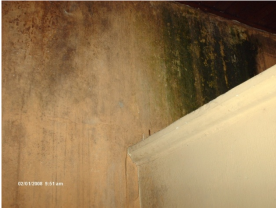
Fotografía 3 Daños por presencia de mohos, y líquenes a causa de la humedad y falta de mantenimiento en las bajadas de agua.
