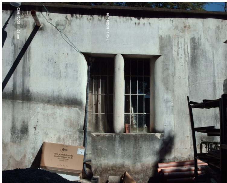
Fotografía 13 Laterales del edificio de CECON se puede observar la presencia de mohos a causa de la humedad
