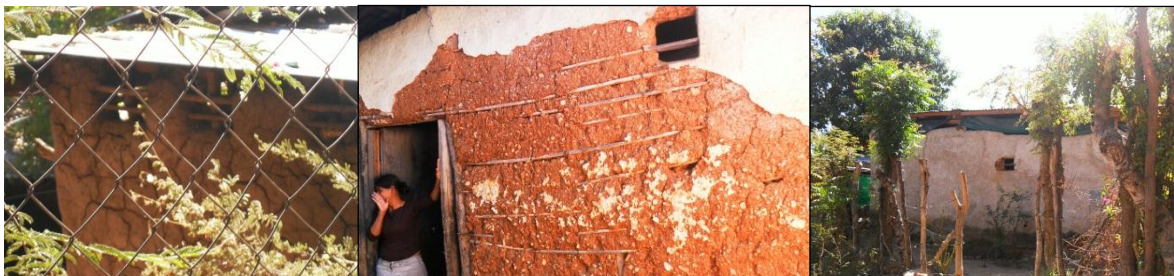
Foto 5/. Ventilación e iluminación inapropiadas en las viviendas/ temperaturas máximas hasta de 38°, Usumatlán.
