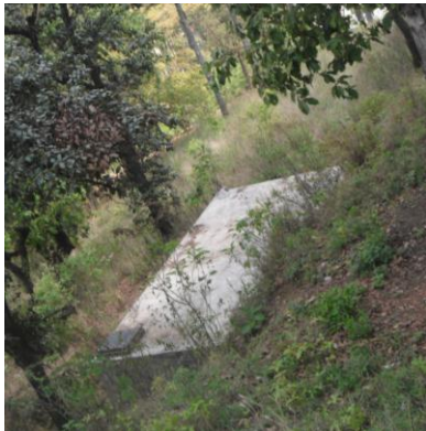
Imagen No. 20 Cisterna Tomada por: Winston Paul Texaj H.
