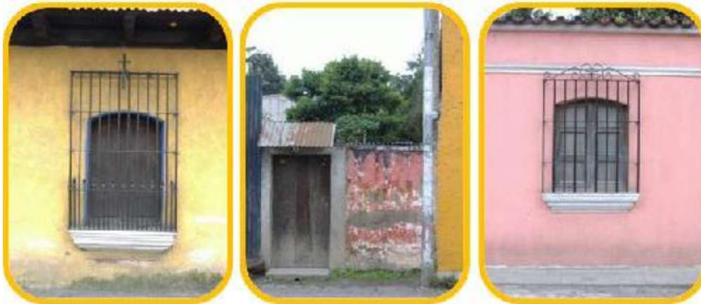
Fotografía 26: Elementos originales deteriorados
