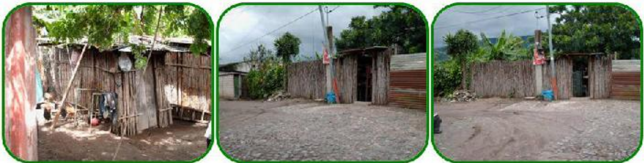
Fotografía 34: Uso de materiales no adecuados
