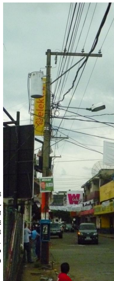
ILUSTRACIÓN 16 POSTE DE LUZ EN LA CUADRA DEL TERRENO DEL PROYECTO CON LÍNEAS DE ALTA TENSIÓN, SE NOTA UN AUMENTO DE CONEXIONES DOMICILIARES. (IMAGEN PROPIA AGOSTO 2011)
