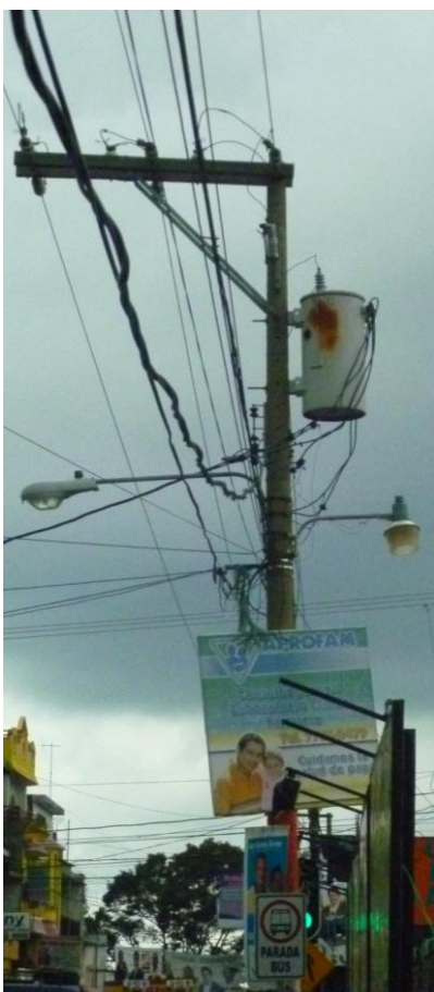
ILUSTRACIÓN 17 POSTE TÍPICO DE ELECTRICIDAD, ALTA TENSIÓN 15000VTS, TRANSFORMADOR A BAJA TENSIÓN 120VTS Y LÁMPARAS DE ENCENDIDO DE FOTO CELDAS. (IMAGEN PROPIA AGOSTO 2011)
