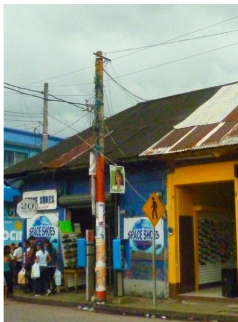
ILUSTRACIÓN 18 POSTE TÍPICO DE TELGUA CON INTERCONEXIONES DOMICILIARES (IMAGEN PROPIA AGOSTO 2011)
