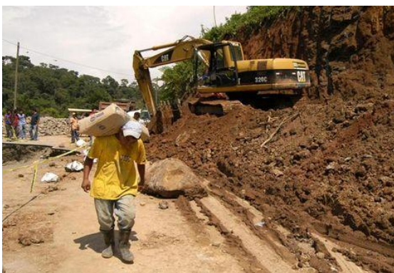
FOTOGRAFÍA 9 DERRUMBE RUTA REFORMA-COATEPEQUE (PRENSA LIBRE, 2008)
