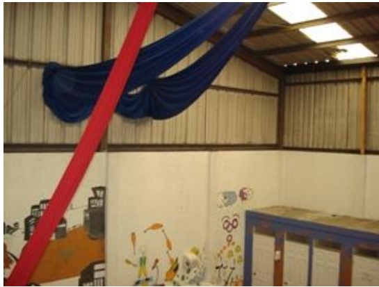
Salón de Ballet Aéreo se observa que el área es muy Pequeña y compartida con el vestíbulo de aulas y baños
