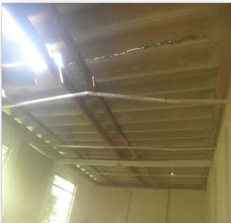
Fotografía No. 25 Deterioro en cubierta Fuente: Elaboración Propia
