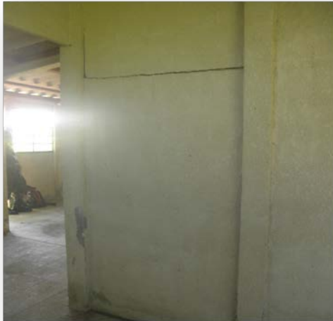
Foto No. 23 Grietas en Muros Fuente: Elaboración Propia
