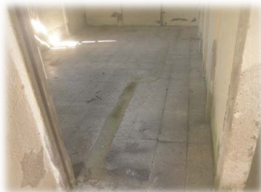
Imagen No. 22 Estado de piso en antigua casa del Comandante de la Base Militar Fuente: Elaboración Propia
