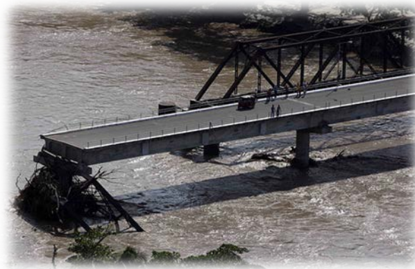
Fotografía No. 6, Daños en la Red Vial durante el paso de la Tormenta Agatha en el año 2010, Puente que comunica El municipio de Los Amates, con la aldea El Rico, Izabal (Fuente: Gobierno de Guatemala/Luis Echeverría)
