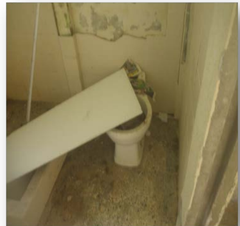
Fotografía No. 26 Sistema de drenajes no cumple con sus objetivos. Fuente: Elaboración Propia
