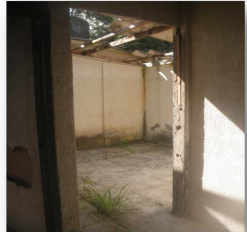
Foto No. 24 Deterioro en cubierta Fuente: Elaboración Propia
