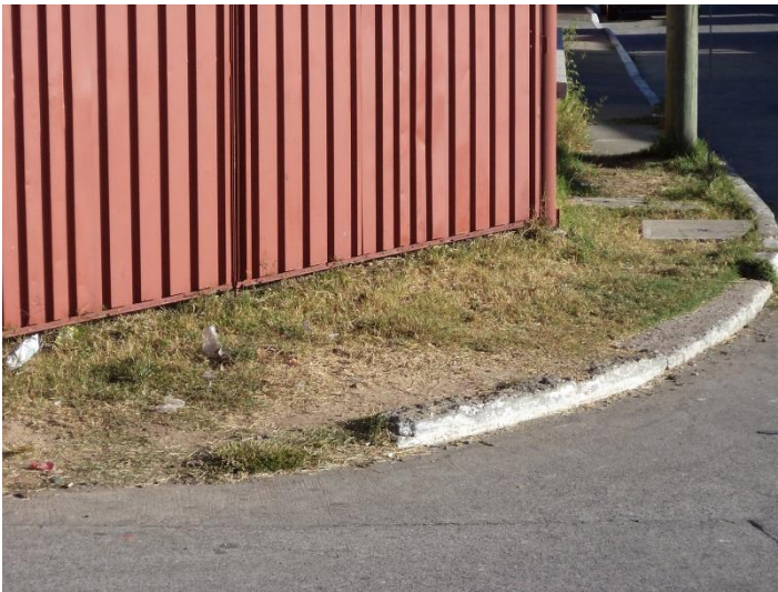
FOTOGRAFÍA No.14: Acera en mal estado. Fuente: Elaboración Propia. Diciembre 2011.
