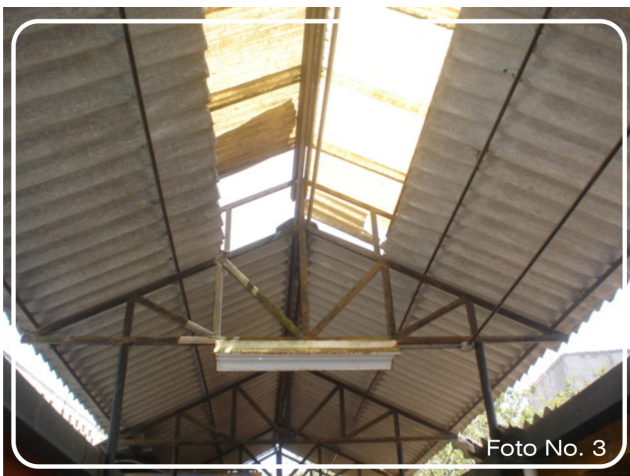
Fotografía No. 3: Las láminas deterioradas indican el poco mantenimiento e inversión que se le da al actual puesto de salud.
