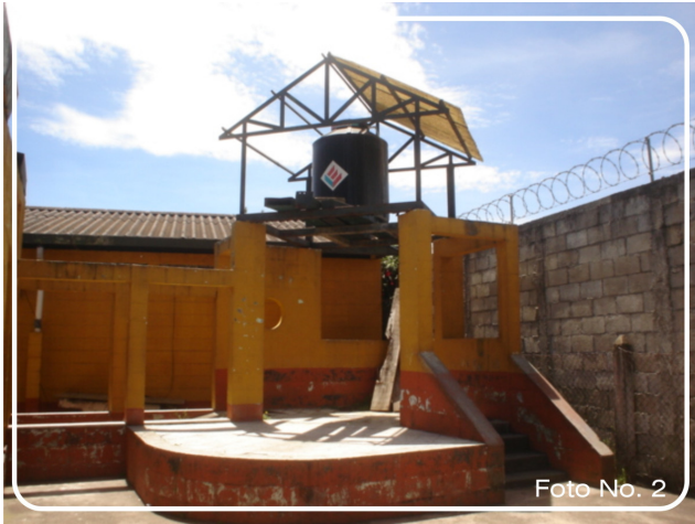
Fotografía No. 2: Se observa la construcción inconclusa y el área improvisada para la colocación del tanque elevado.
