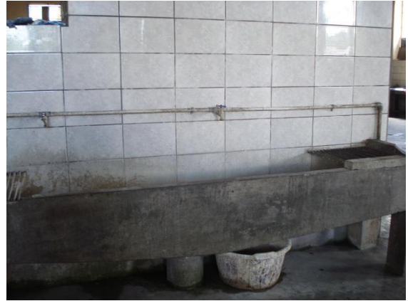
PILETA DE LAVADO DE VÍSERAS
