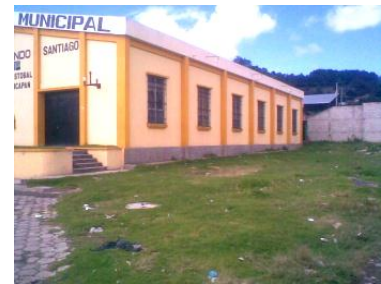
Fotografía F Teatro Municipal al costado del terreno donde se observa el desnivel de 1.5 metros del nivel del suelo Fotografía tomada 03-03-2011 19
