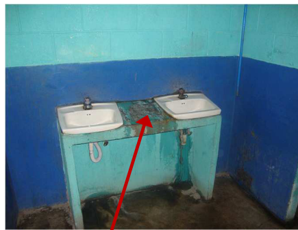
Lavamanos en Mal Estado
