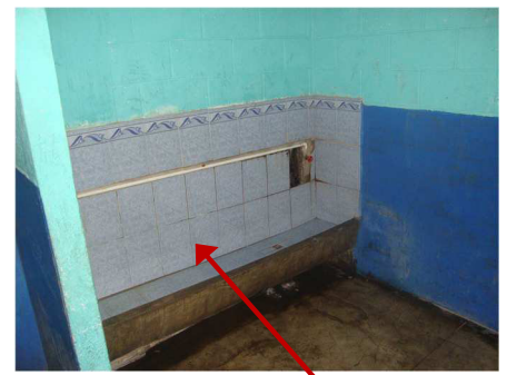
Urinal Colectivo con Instalaciones Inadecuadas
