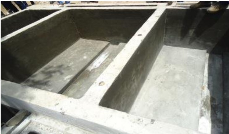
Fotografía No. 12. Cajas para tratamiento de las aguas grises, agua pluvial y municipal.
