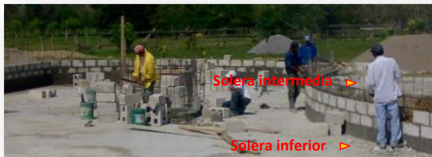
Foto no 139 observar cómo se logra nivelar el fondo del piso y la solera intermedia, utilizando la solera de entramado con diferencia de alturas según el desnivel del piso. Foto: Oscar López
