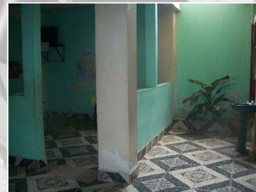
Fotografía 5: En el primer nivel existen áreas de estar y servicios sanitarios con falta de ventilación y que se encuentran alejados de las áreas de los migrantes, por lo que deben ser reubicados.
