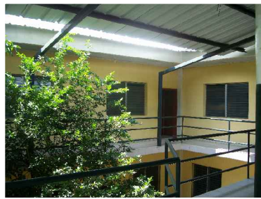
Fotografía 7: Vista de las circulaciones horizontales en el 2do. nivel, tienen un ancho de 0.90 mts, y cuentan con una baranda de acero que puede representar riesgo de accidente para un niño que viaje con sus padres.
