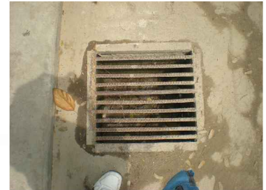
Fotografía D: Cajas de Drenajes de Agua Pluvial, 2 frente al terreno, estos se encuentran a las orillas de ambas calles.
