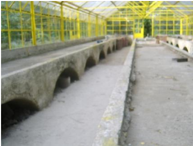
Fotografía 34: Pila central y laterales de ladrillo, declarada bien Patrimonial Histórico de Guatemala, en estado de deterioro.
