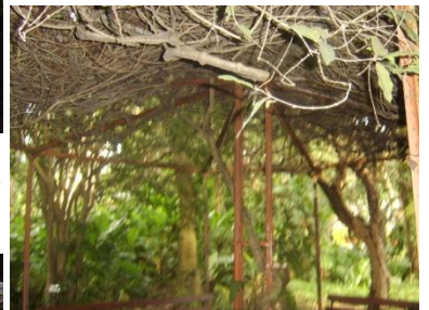
Fotografía 45: Estructura metálica con uso de quiosco, deteriorada por oxido.
