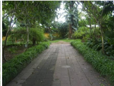
Fotografía 36: Se puede observar el deterioro de las baldosas de barro el cual ha provocado caídas entre trabajadores y visitantes.
