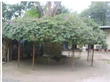
Fotografía 47: Estructura metálica con uso de quiosco, deteriorada por oxido. Al fondo área de jardineros.
