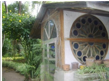
Fotografía 39: Casa de Información antes de prestarle mantenimiento.
