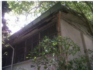
Fotografía 40: Edificio de las instalaciones del CEFOL. En estado de deterioro.
