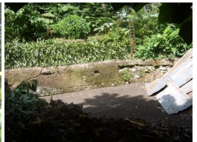
Fotografía 32: Muro erosionado por el tiempo en el área actual de la abonera, requiriendo infraestructura adecuada.
