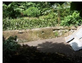
Fotografía 63: Muro de Contención bajo existente en el área disponible para el Umbraculo. Jardín Botánico, Guatemala, 2011.
