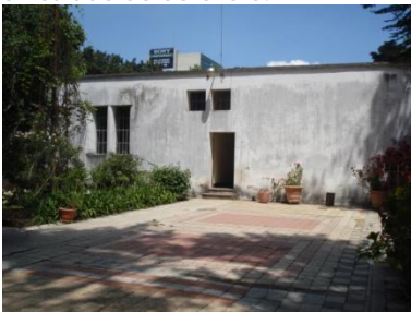
Fotografía 38: Muro orientación Este entre oficinas de CECON y Jardín Botánico, deteriorado por inclemencias del clima.
