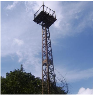
Fotografía 29: Estructura metálica con uso de observatorio, deteriorada por el oxido.
