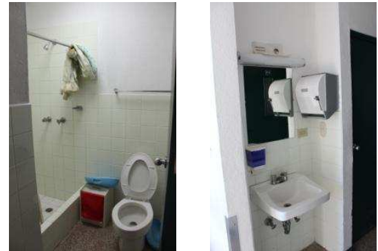
Servicio sanitario y lavamanos en habitación
