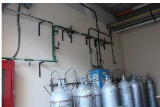
Manifold de tanques de Oxígeno.
