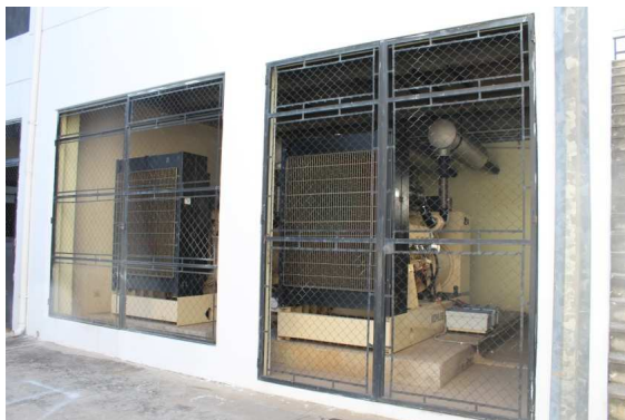
Plantas eléctricas de emergencia
