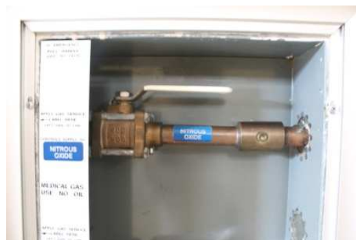
Llave de paso de instalaciones de oxígeno y oxido nitroso dentro del edificio.
