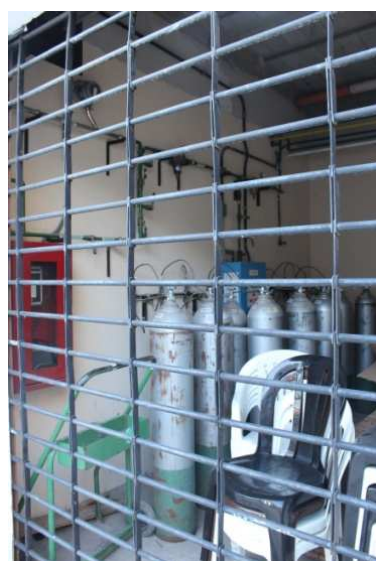
Ubicación de los tanques de oxígeno hacia el exterior
