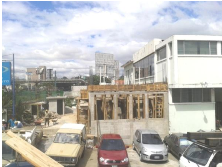
Vista actual del proyecto en construcción del proyecto Clínicas de Cirugía Ambulatoria "Tecún Umán
