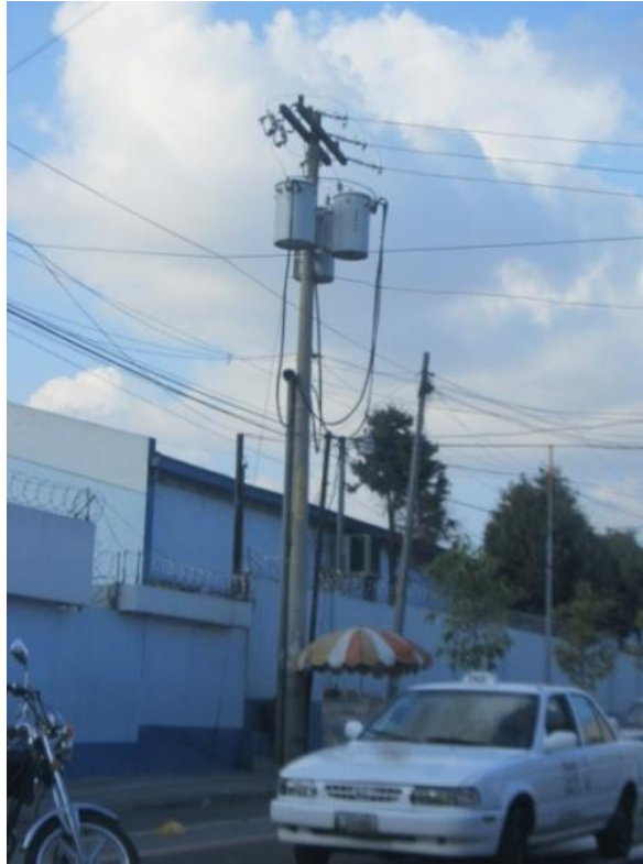
Vista de transformadores donde actualmente se conecta la Unidad Periférica, zona 11
