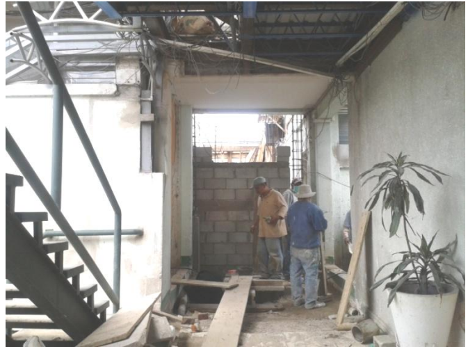
Vista actual de cerramiento entre la División de Mantenimiento y Clínicas de Cirugía Ambulatoria "Tecún Umán"
