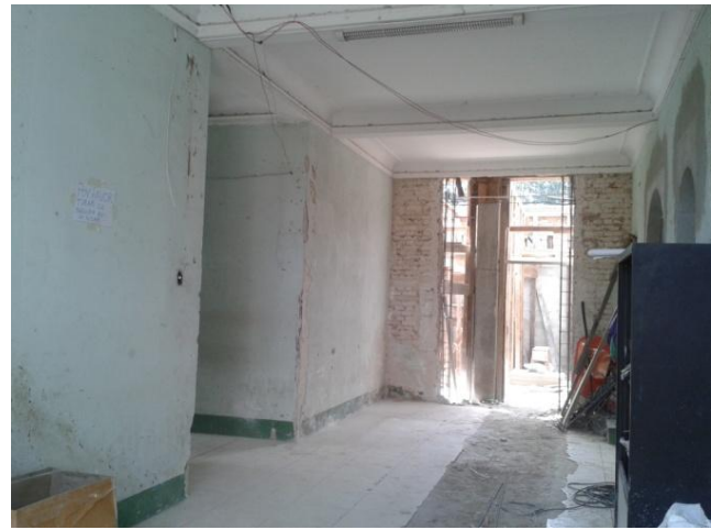
Vista actual del al proyecto de Clínicas de Cirugía Ambulatoria “Tecún Umán”, en el mismo terreno de la División de Mantenimiento
