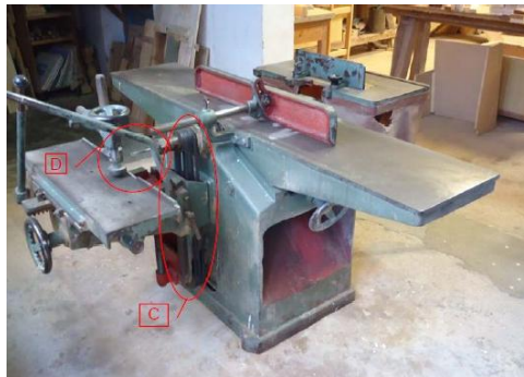
Vista de Equipo instalado en la Carpintería (Escopleadora, cepillo y disco/fresas)
