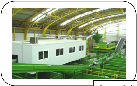
Foto no. 5 vista del recorrido de los desechos sobre la faja de separación que los envía a distintas maquinas para su prensado u otro destino que se le disponga
