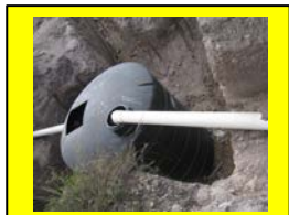
Foto 7. La tubería llega a un tanque que no es más que el que recibirá toda la materia de las fosas a través de un drenaje francés, que acumulara toda la materia y gases.
