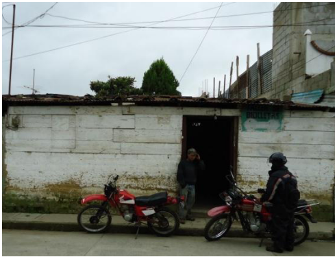
Fotografía No. 42 Vivienda ubicada la Avenida Rafael Álvarez Ovalle del municipio (Zona 1), en la cual solo se conservan los muros ya que el techo fue cambiado de teja a lámina de zinc. Captura Propia
