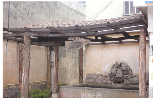
Nazareno es una de las pocas pilas que le dan mantenimiento. Captura propia
