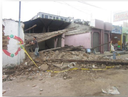
Fotografía Terremoto 7 de Noviembre, San Marcos, Fuente Autor. Diciembre de 2012
