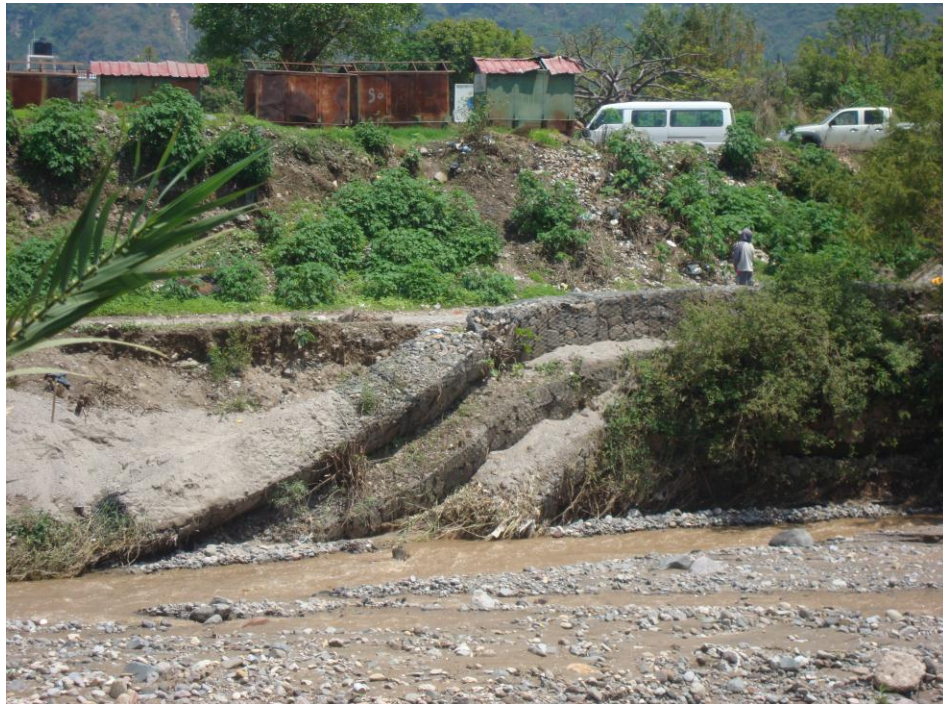
Gaviones Colapsados, Río San Francisco, Panajachel, Sololá.
