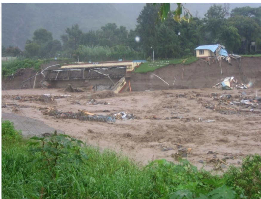
Foto: PLANTA DE TRATAMIENTO DE AGUAS RESIDUALES DAÑADA POR LA TORMENTA STAN Fuente: Municipalidad de Panajachel 2005.
