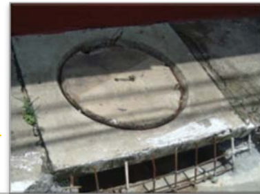
IMAGEN No. 17 Drenaje Municipal, reposadera. [Foto tomada en el lugar, Fuente: elaboración propia]
