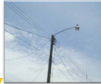
IMAGEN No. 16 Poste Eléctrico. [Foto tomada en el lugar, Fuente: elaboración propia.]
