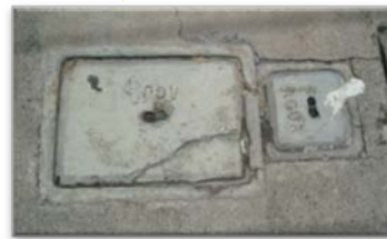
IMAGEN No. 18 Acometida de Agua Potable. [Foto tomada en el lugar, Fuente: elaboración propia.]
