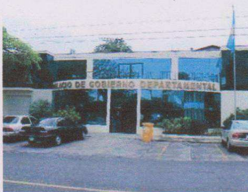
Fachada de la sede de construcción que alberga dependencia en El Progreso, la cual tiene daños estructurales, pese a que fue inaugurada en el 2008.
