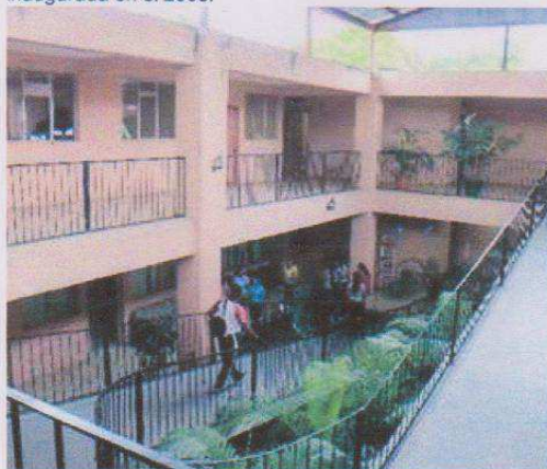
El edificio produce oscilaciones debido a los daños en la estructura.
