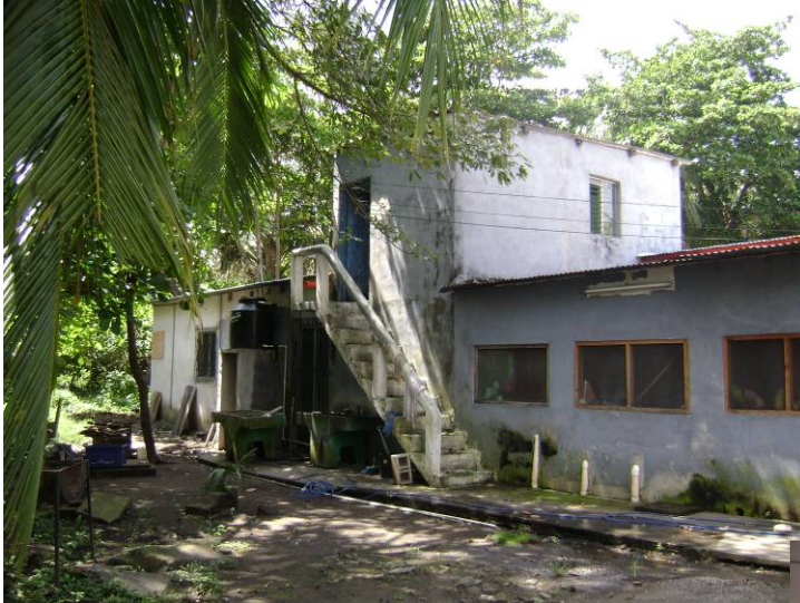
Foto 4: Vista de cocina y comedor, donde se alimenta a los cadetes y civiles de marina mercante. Las instalaciones son inadecuadas para dichas actividades.
