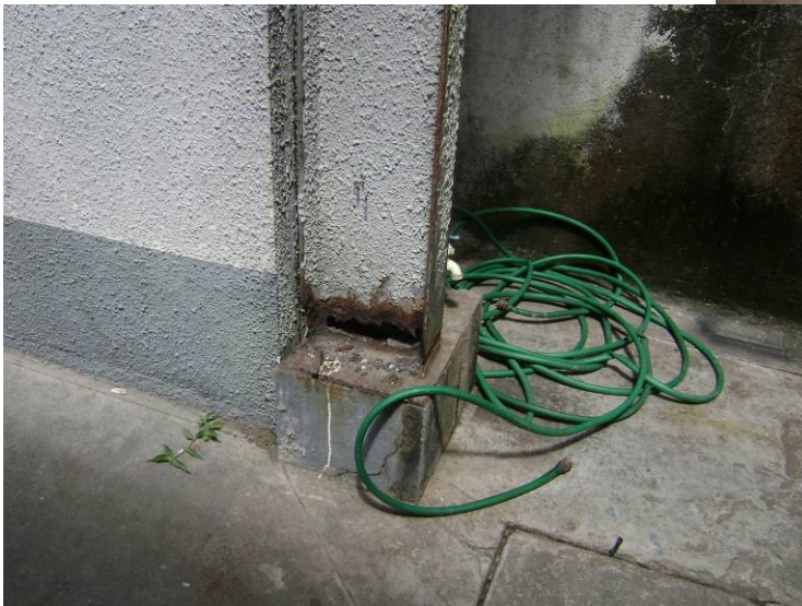
Foto 6: Daño en las estructuras metálicas en sollados (dormitorio en terminología naval). Instalaciones en mal estado en general.
