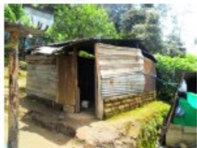
Fotografía No.28: Vista exterior de la cocina de adobe y laminado galvánico. Fuente: Juan Arévalo.
