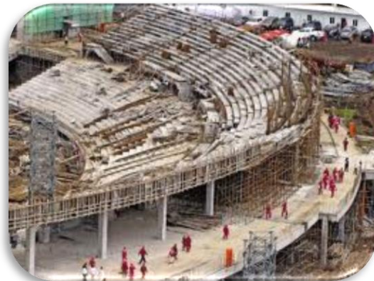
Fotografía No. 22 Vista Aérea del proceso de Construcción del estadio de Costa Rica
