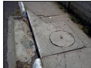
Tragantes existentes agua pluvial
