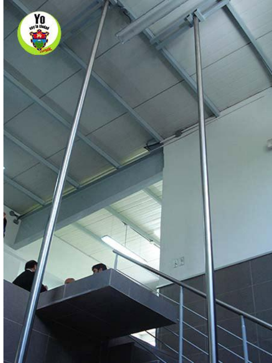
IMAGEN N. 49 Área de tubos descenso con soportes/ Fuente Munigate.com
